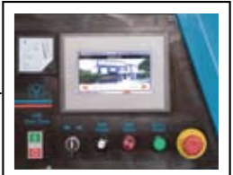
PLC电脑控制方式 PLC control mode
